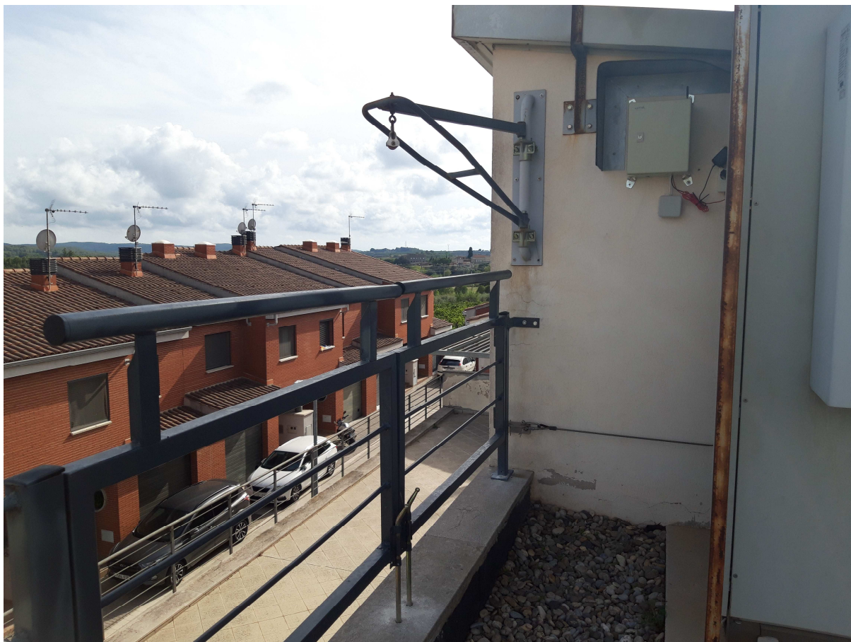
Figura 2. Equip instal·lat a Antistiana.
