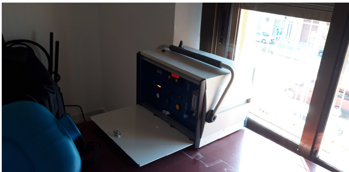
Figura 2. Equip instal·lat a les Escoles Velles (La Ràpita)
