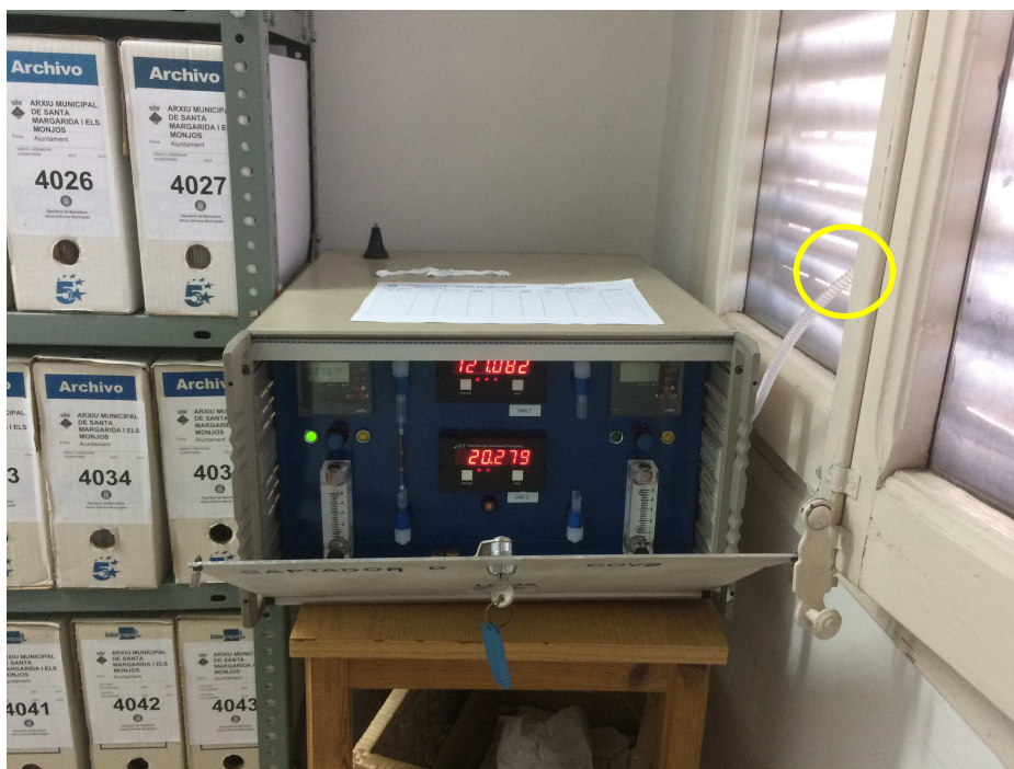
Figura 5. Equip instal·lat a l'Ajuntament i punt exterior de presa de mostres (Els Monjos)
