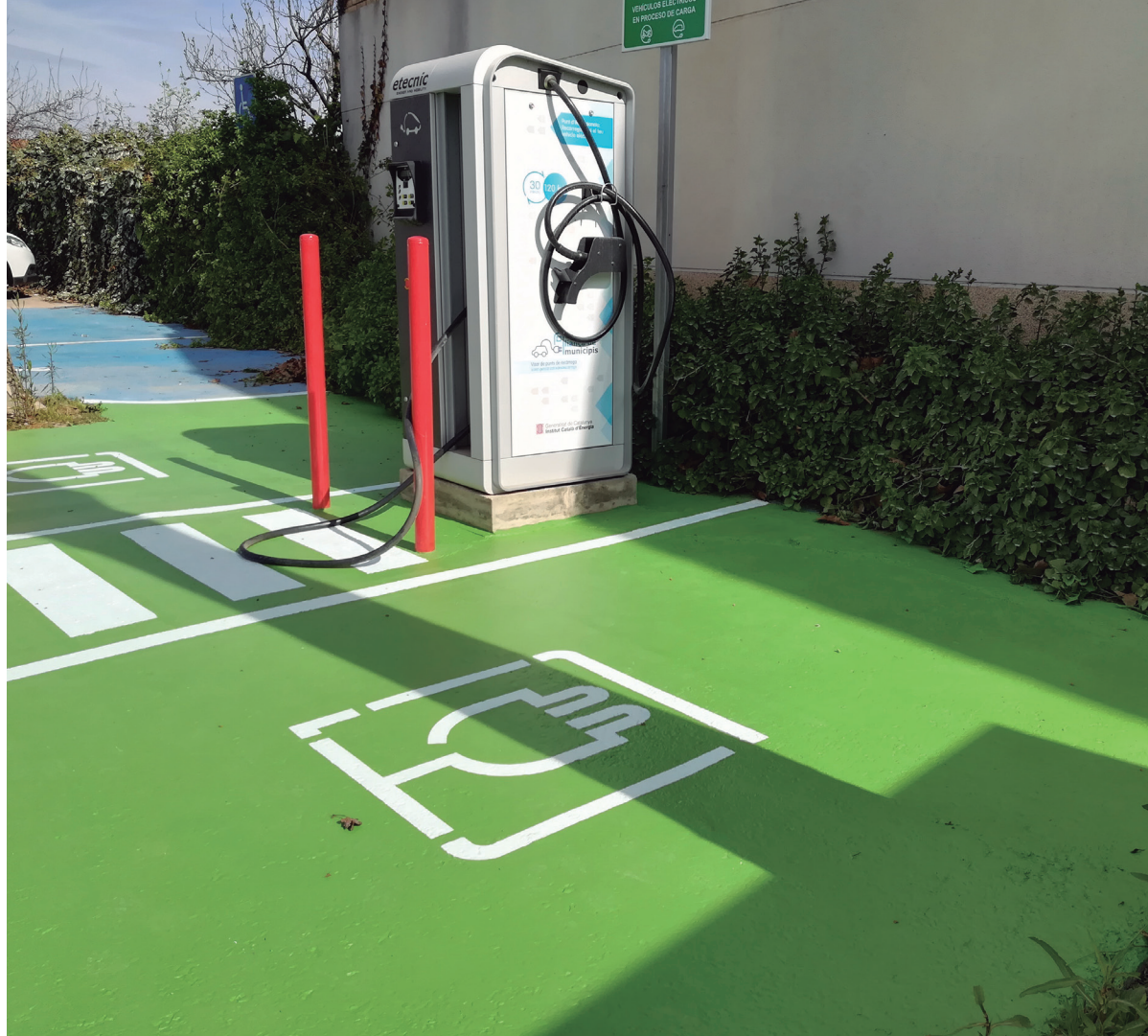
El punt de recàrrega de vehicles està al pàrquing de l'Avinguda Catalunya.
